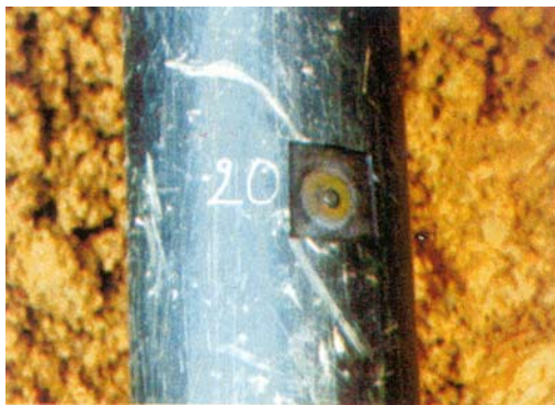
Photo 2 : Oxyde (40 x 40 mm) et produit de corrosion
