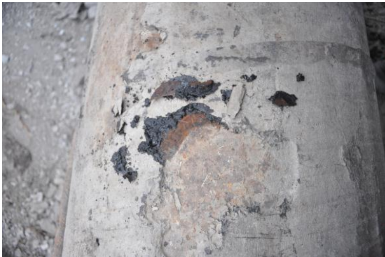
Abb. 1: Fehlstelle an der Aussenumhüllung einer Rohrleitung
