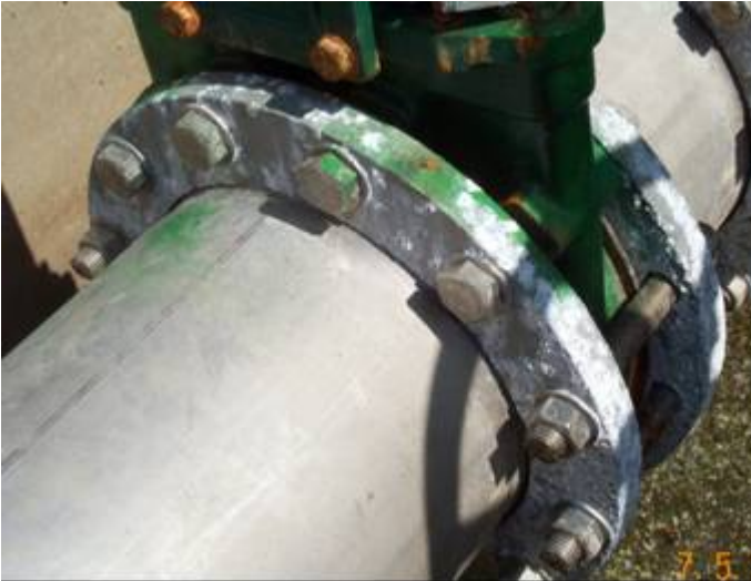
Figure 3 : Bride aluminium sur canalisation inox
