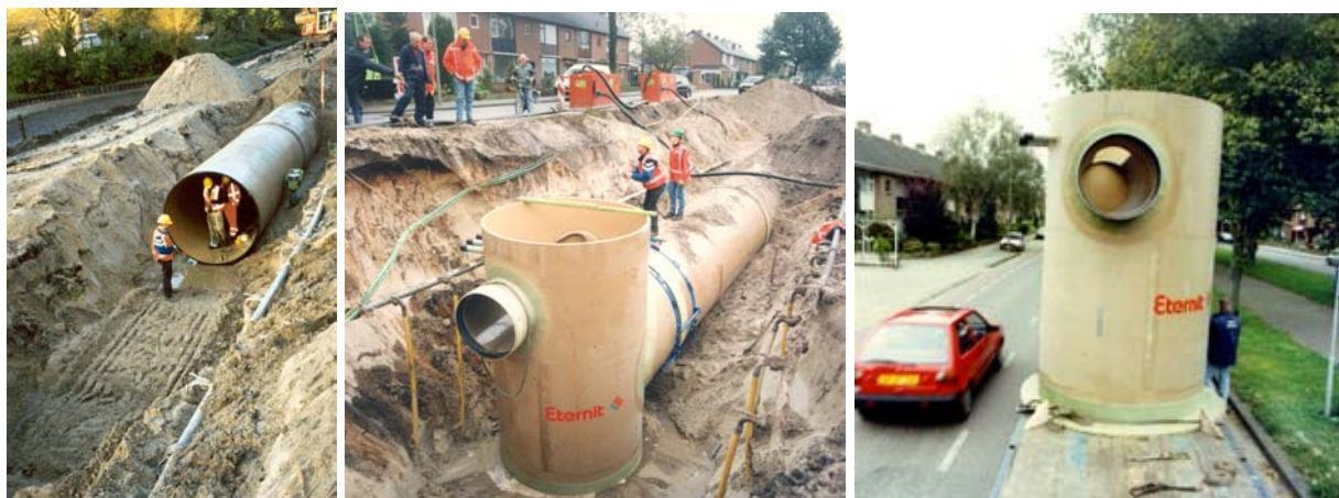
Bassin de rétention DN 2200 avec chambre déversoir et puisard de pompage préfabriqué.
