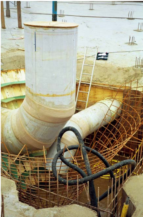
Bassin de décantation - Puisard des boues Tubes d'entrée de l'effluent et d'évacuation de boue
